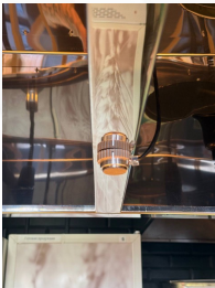
Установка на потолке
